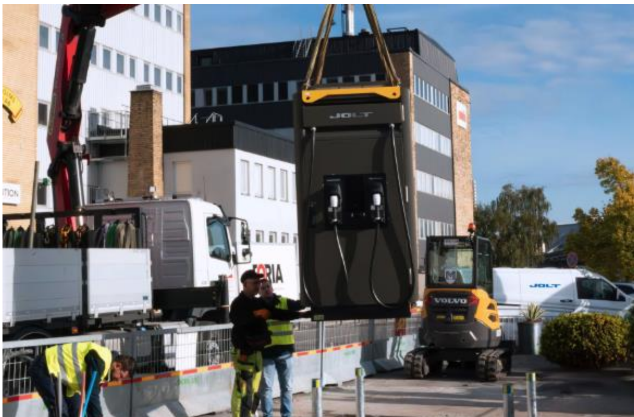
Рисунок 23 – Встановлення зарядної станції високої потужності від відновлюваних джерел енергії для електроавтомобілів у м. Стокгольмі (джерело: www.jolt.energy )
